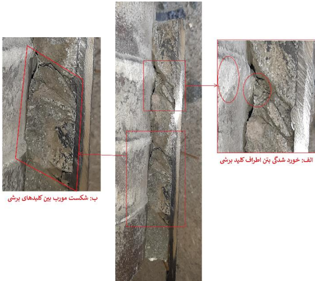
شکل ۱۱ - مود شکست بتن بدون الیاف (الف) خورد شدگی بتن اطراف کلید برشی (ب) ترک مورب برشی
