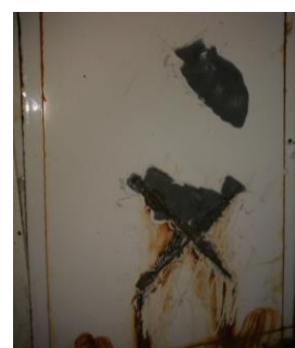
شکل ۱۶- ارزیابی سطح فلز پس از اتمام آزمایش مه نمکی و حذف لایه پوشش
