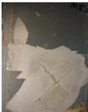
شکل ۱۲- وضعیت سطح فلز پس از اتمام آزمایش مه نمکی و حذف لایه پوشش
