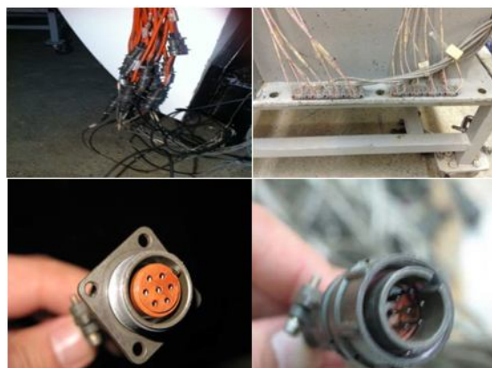
شکل ۱۳- تصویر اتصالات به کار رفته برای سیستم انتقال داده از سنسورها
