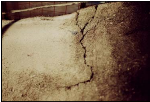
شکل ۵- الف- ایجاد آسیب در رویه آسفالتی به ازای شیب خاکریز ۱:۳ و شستگی مصالح زیر رویه، ب- ترک ایجاد شده در رویه آسفالتی
